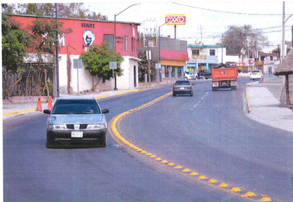
La renovación fue total en el Boulevard a lo largo de 4.5 kilómetros, pues incluso se cambió el drenaje pluvial
